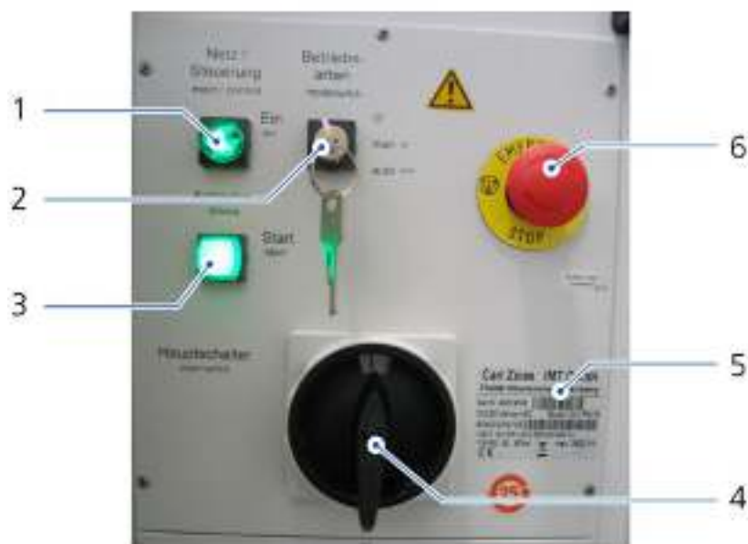
图 9-11 控制柜 MCC800 - 操作元件
